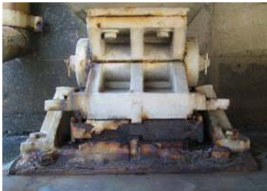
漏水による支承の劣化
