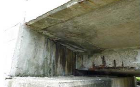
漏水による桁端部の劣化
