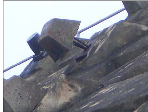
アンカー頭部の腐食・破断
