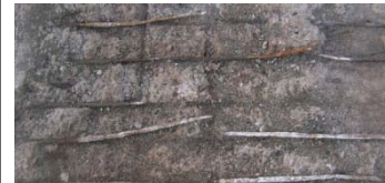
コンクリート橋の著しい劣化
