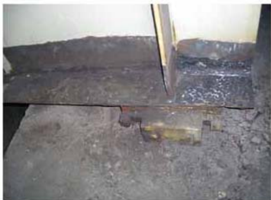
漏水による桁端部の劣化
