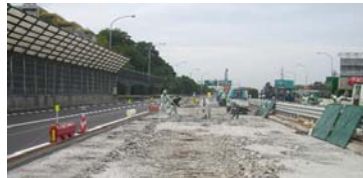
床版の著しい劣化
