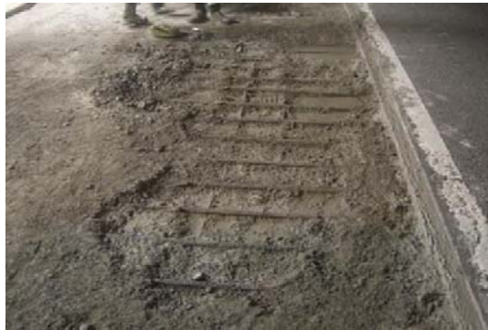
床版上面の劣化
